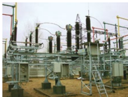
Подстанция №89 110 кВ (ОАО «Ленэнерго») на основе БМК «Исеть»
