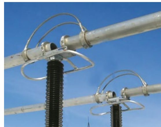
Жесткая ошиновка 500 кВ производства ЗАО ПФ «КТП-Урал» на испытаниях в НИЦ ВВА
