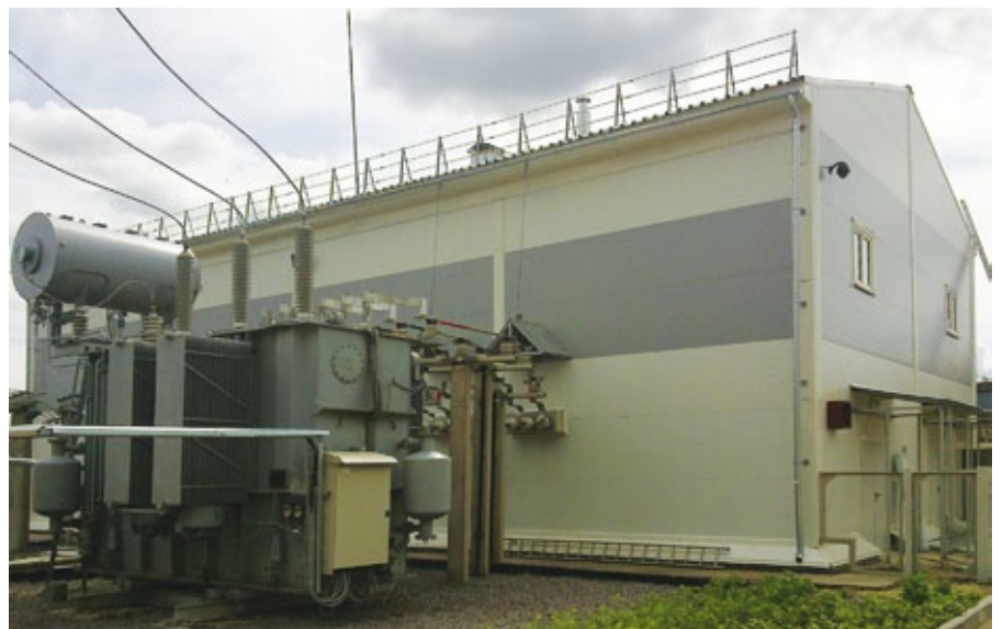
ПС 110 кВ «ГАС-2» (Нижегородская область)
