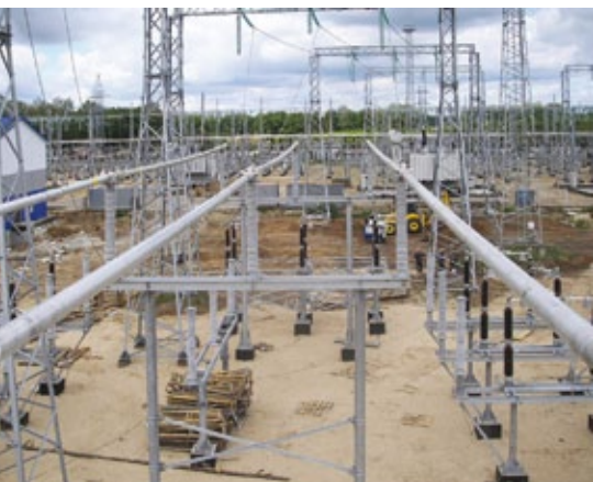
Подстанция 220 кВ «Мичуринская»
