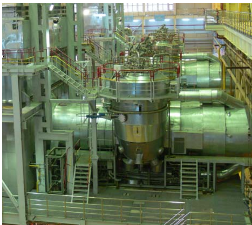
Рисунок 1. Газотурбинные установки ГТЭ-160 в составе блока ПГУ
